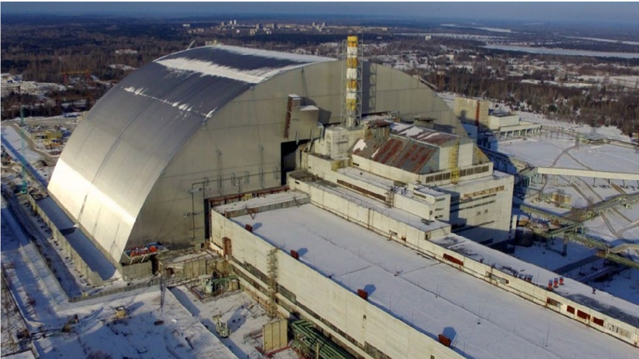
NSC nach der Verschiebung und Positionierung über dem Block 4 – Blick aus östlicher Richtung
