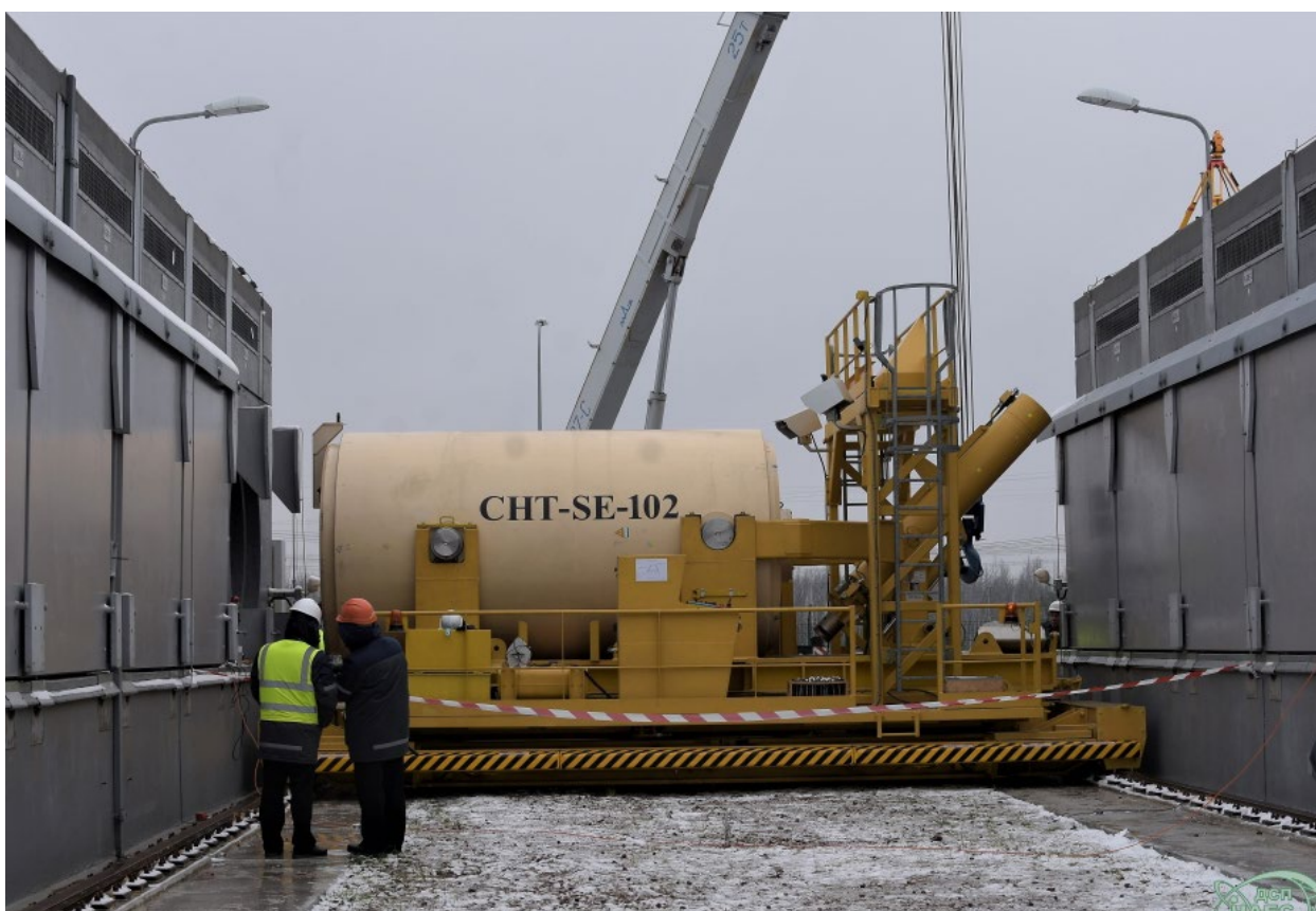
„Kalter“ Test der Belademaschine für doppelwandige Behälter mit bestrahlten Brennelementen zur Einlagerung im Trockenlager ISF-2 im Januar 2018
