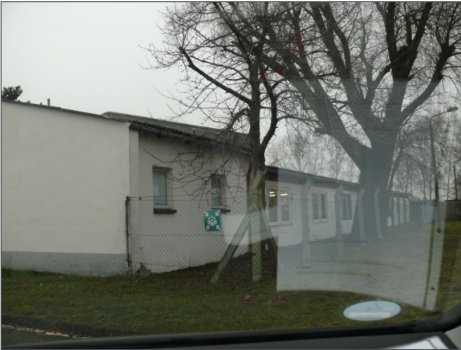
Abbildung 26: Gebäude mit Asbestdach
